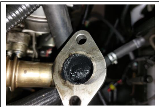
Ducto de la válvula EGR al cuerpo de aceleración con hollín y aceite
